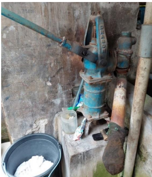
Gambar 2. Pompa Tangan Eksisting
